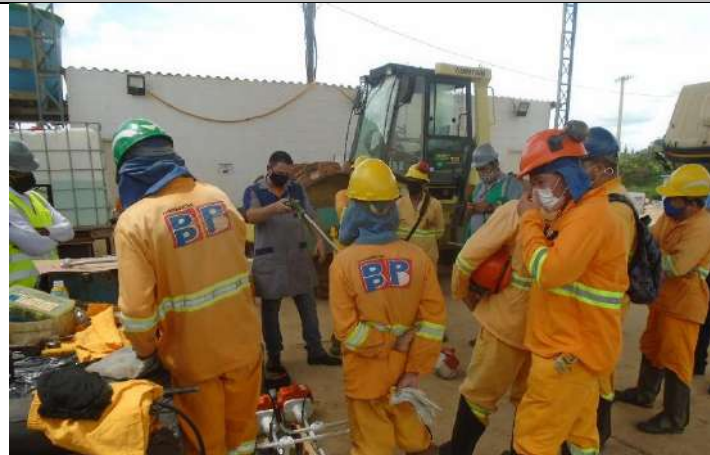
Foto 2 – Trabalhadores recebendo orientação técnica sobre a manutenção do equipamento. Data: (18/01/2021)
